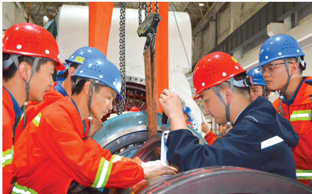
国家电投贵州金元股份公司充分利用教培中心、实训基地、工匠坊等资源，以生产现场为练兵场所，打磨职工专业技能。图为“设备缺陷清零”劳动竞赛现场。
